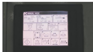
Control PLC de pantalla táctil
